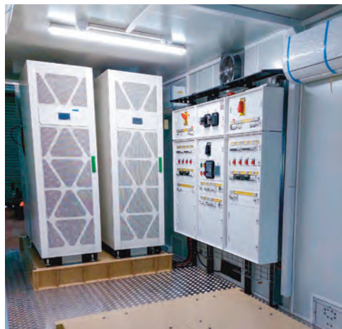
2x60 kVA redondant, avec possibilité d'augmentation de puissance à 2x120 kVA
