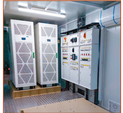
2x60 kVA redondant, avec possibilité d'augmentation de puissance à 2x120 kVA
